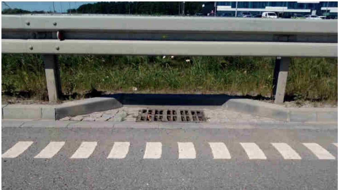
Fot. Nr 4,5 Wpuść deszczowy cofnięty poza krawędź nawierzchni
