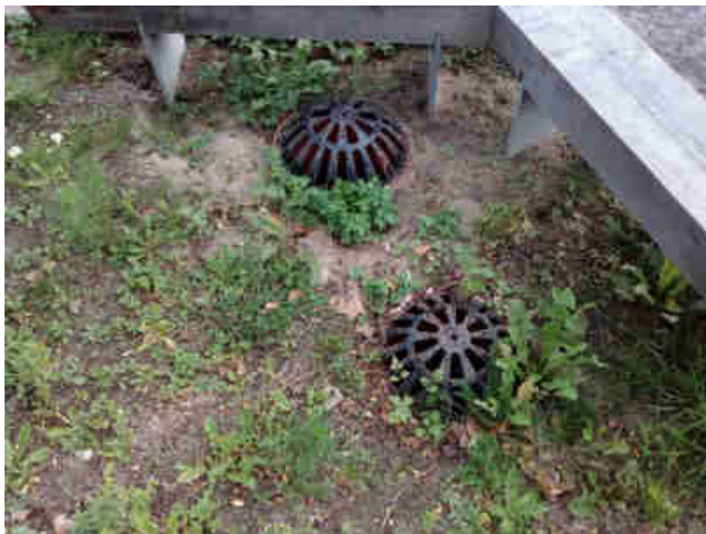
Fot. Nr 2 Wpust kopołowy
